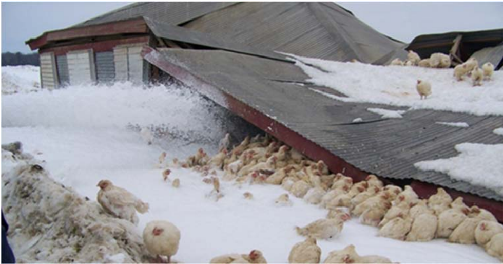
Foto 19. Utilización de espuma en gallinero con daño estructural.
